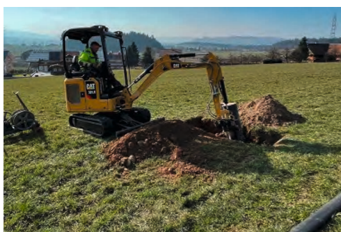
André Zimmermann, Leiter Wassernetz, beim Erstellen des Zugschachts für das LWL – Steuerkabel
