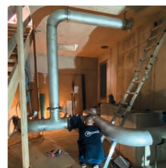
Edelstahl - Rohrleitungsbau im Reservoirkeller
